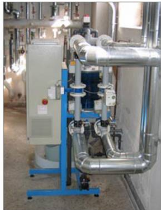
Kalt- und Warmwasseranschlüsse
